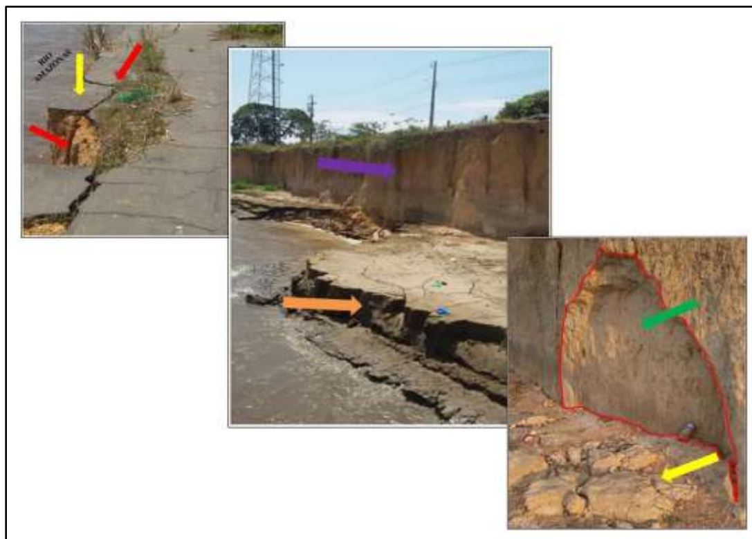
Figura 2: Processos erosivos na orla da cidade de Parintins
