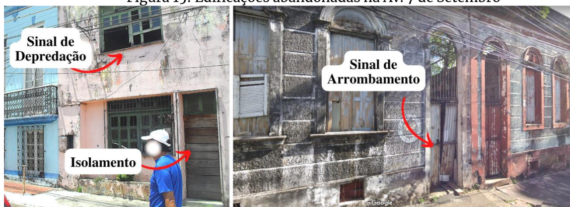
Figura 15: Edificações abandonadas na Av. 7 de Setembro
